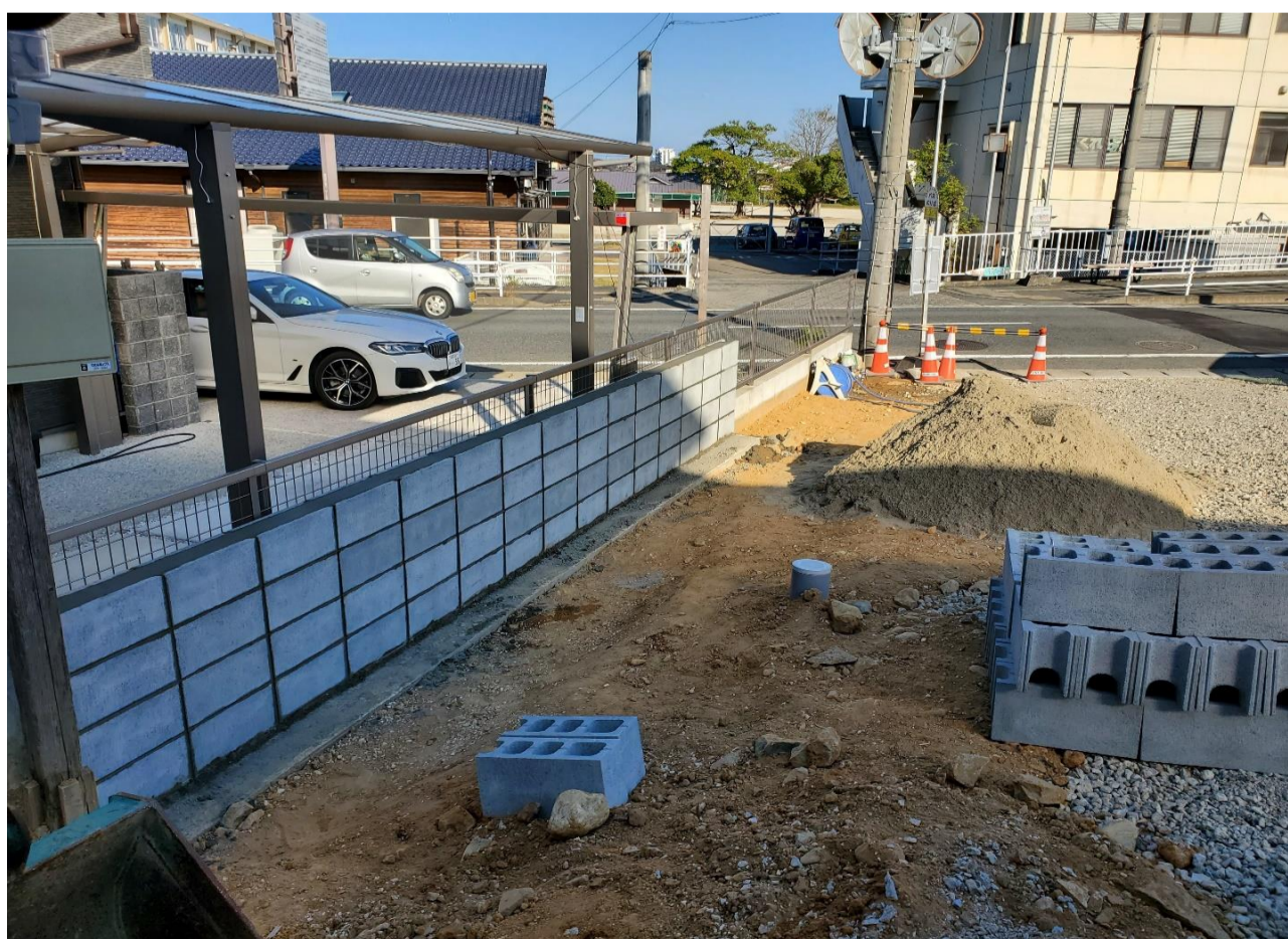
ねじれ地を整形地化する為に北側隣地との間にブロックを4段付く
